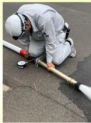
消火ホース流量測定 (ノズルに圧力計を設置して行う)
